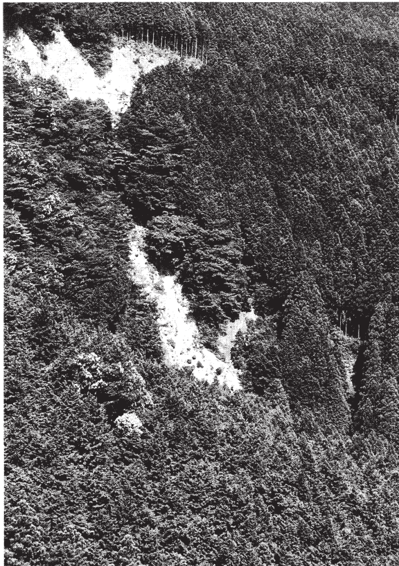
図4 崖錐除去工事前の月出露頭。 中央右部の黒灰色部が黒色片岩、中央左部の白色部がマイロナイト。 (1994年7月撮影)
