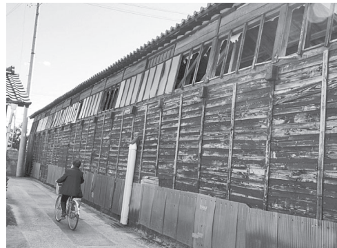
写真3-2 廃業した古い工場のガラス窓はあちこちが壊れている
