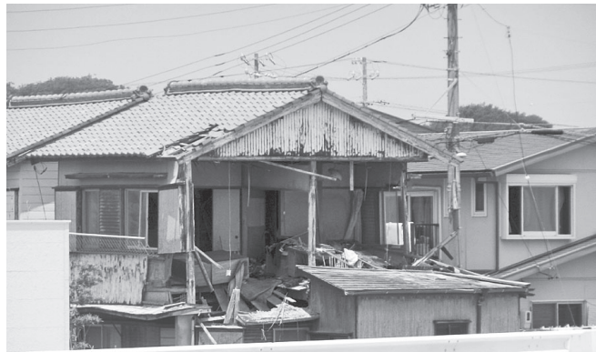
写真10 既に半壊して室内が見えている空き家
